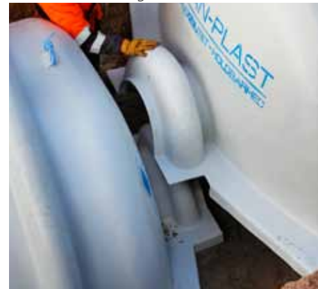
Regnvandstunnellerne samles ved sammenkobling
