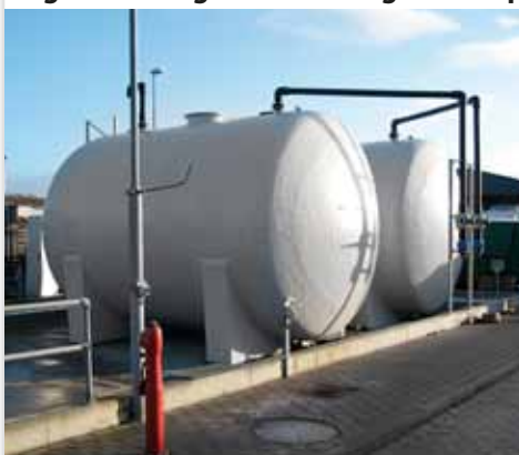
Lageranlæg til saltopløsning med horisontale tanke i sadler stående i sikkerhedsgrav
