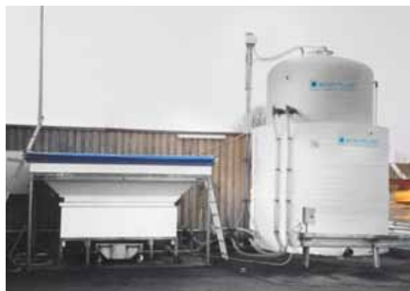
Komplet anlæg med blandedanlæg, lagertank med miljøsikkerhedskar samt pumpearrangement for påfyldning
