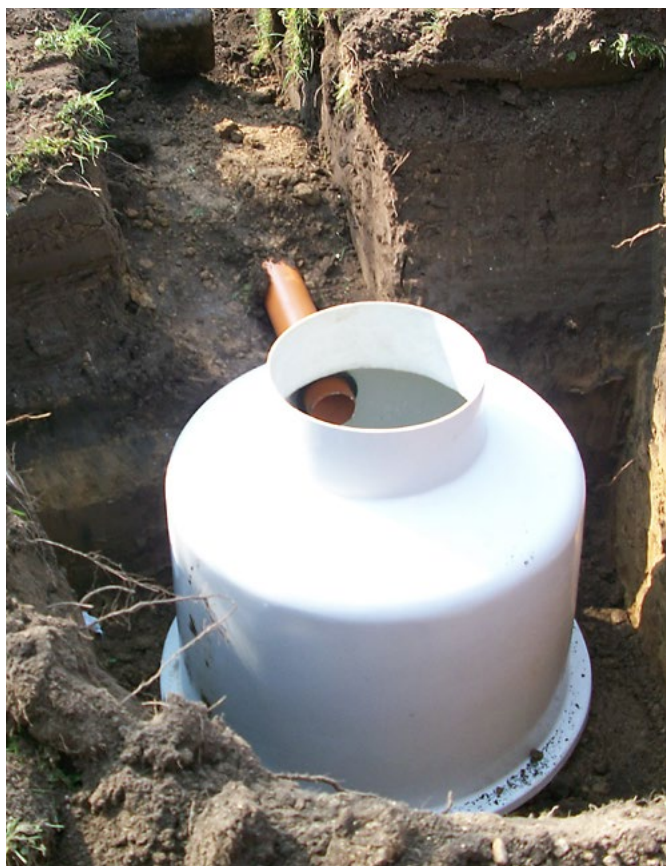
Faskinetank med stuts for rør og med opdriftssikringsfod.
