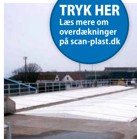
Overdækning af processtanke på et renseanlæg
