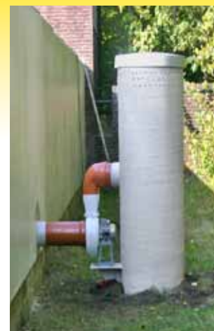
Kulfilter ved indløbsbygværk
