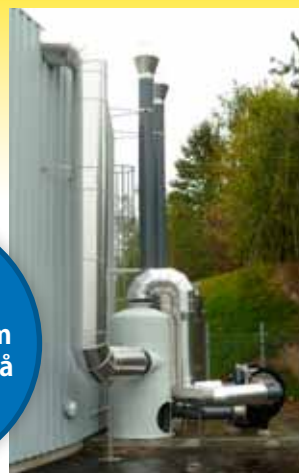
Kulfilter ved slamanlæg
