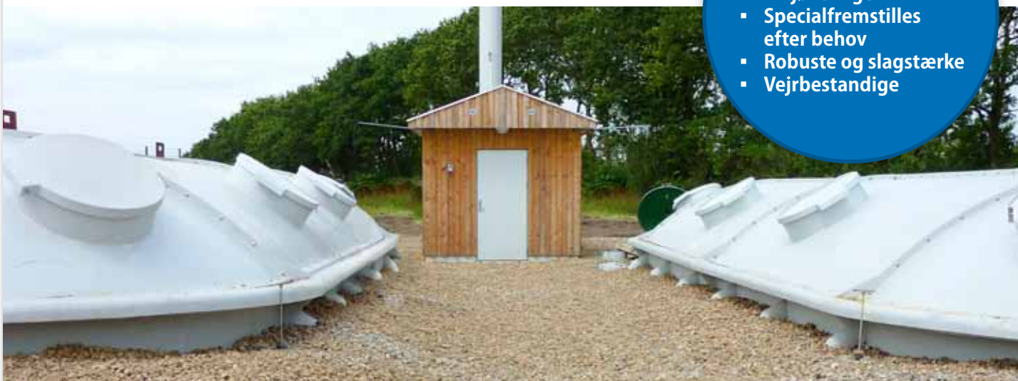
Barkfilteranlæg til lugtrensning af luft fra biogasanlæg
