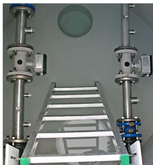
Installationsbrønd med flowmålere.
