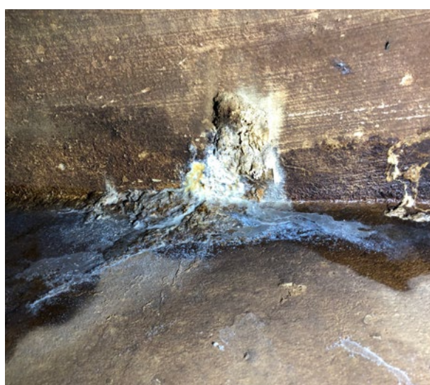
Gennemgående revner i rentvandstank. Det ses tydeligt, at der sker en indsvkning af udefra stående vand og dermed en bakteriologisk forurening af drikkevandet.
