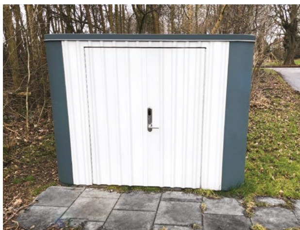
Installationskabinet type F med sedum tagbeplantning.
