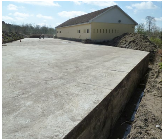
Ældre beton rentvandstanke er ofte utætte grundet store gennemgående revnedannelser.
