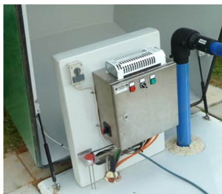
Installationskabinet type A. Måleudstyr er monteret på den skruefaste montagetavle.
