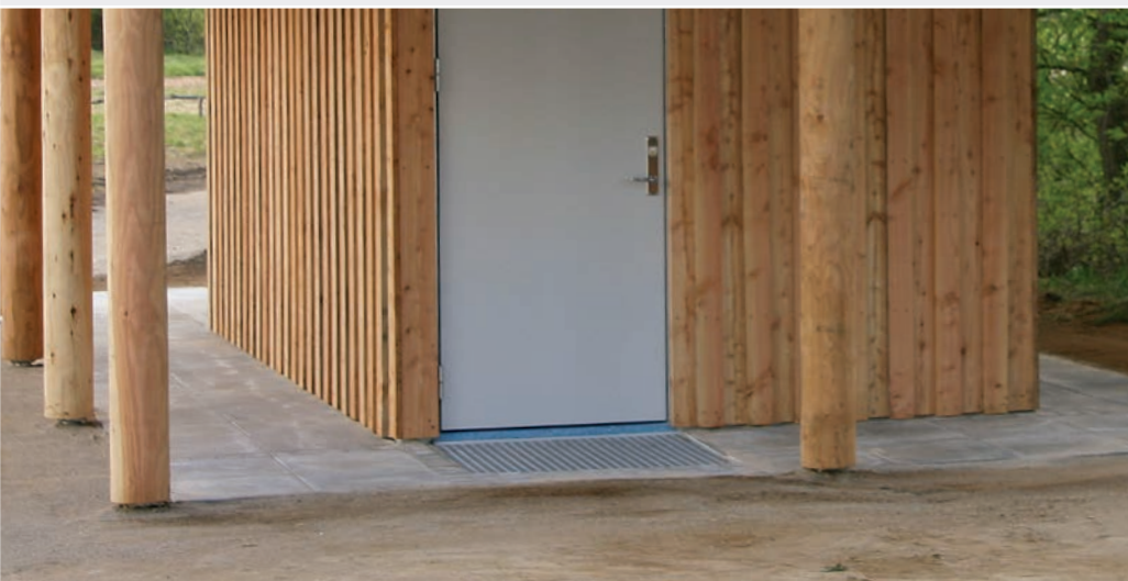
Решетка для вытирания обуви с поддоном установлена у входа в туалетный домик
