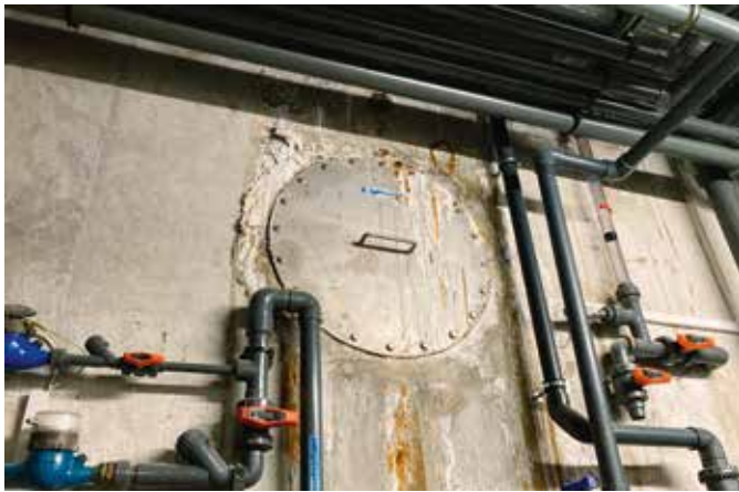
Simple principper for bevarelse af tætheden ved huller skal følges, da det ellers hurtigt afsløres. Her ses et eksempel på et mandehul i Lyngby Svømmehal, der ikke er etableret korrekt for cirka 10 år siden.
